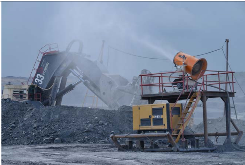
Foto 9. Cañones de niebla instalados en las áreas de operación de las palas.
