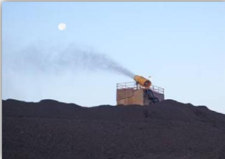
Foto 11. Cañón de niebla instalado en el área de acopio de carbón.
