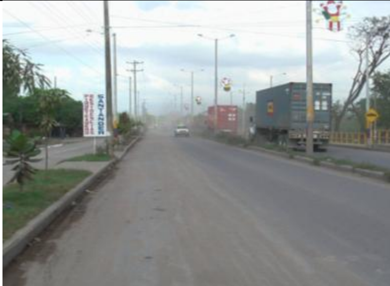
Foto 19. Estado de vías antes de realizar labores de limpieza
